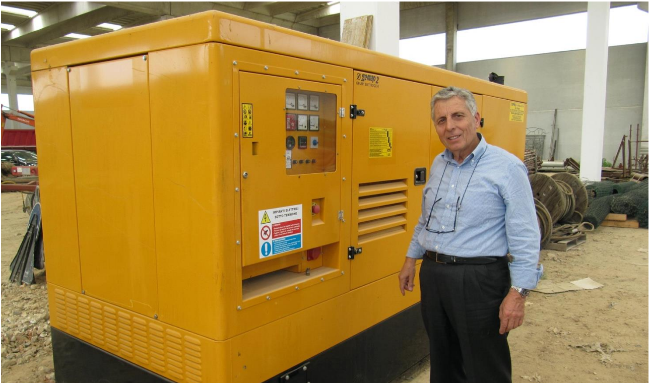
Piergiorgio Benzi posa davanti al generatore donatoci dalla sua ditta
